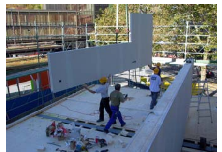
Bild 8 Die vorgefertigten Decken- und Wandelemente ermöglichten eine kurze Montagezeit von nur drei Wochen.
