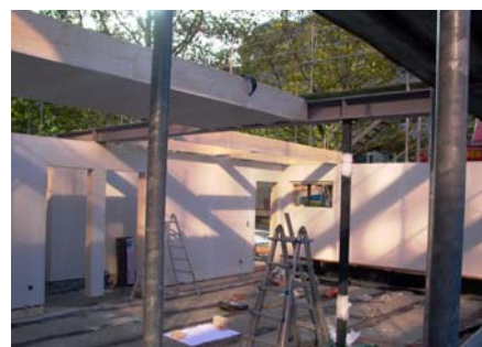
Bild 7 ... werden zwischen die Flansche eines mittig verlaufenden Stahlträgers, der als deckengleicher Unterzug fungiert, eingeschoben.
